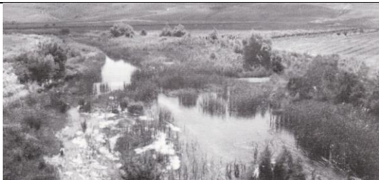
Torrente Pozzo Fieto: Alveo invaso da vegetazione.
