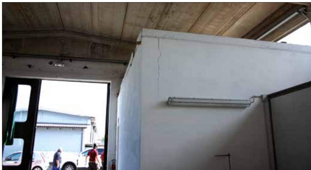
Figura 5.48: Danneggiamento del blocco aggiunto interno: fessurazione verticale non passante in corrispondenza di due pareti ortogonali. Livello di danno complessivo: D1 (terremoto Emilia-Romagna 2012, San Felice sul Panaro (MO))
