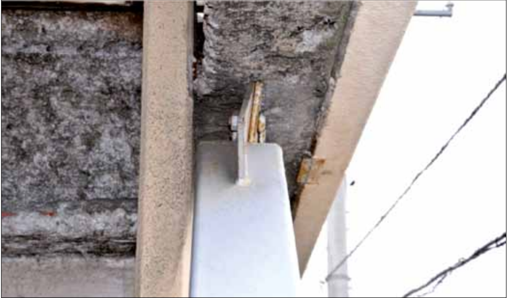
Figura 5.41: Instabilizzazione di un fazzoletto metallico utilizzato per il collegamento telaio - diagonale di controvento. Livello di danno: D2 – D3 (terremoto di Tohoku, Giappone 2011)
