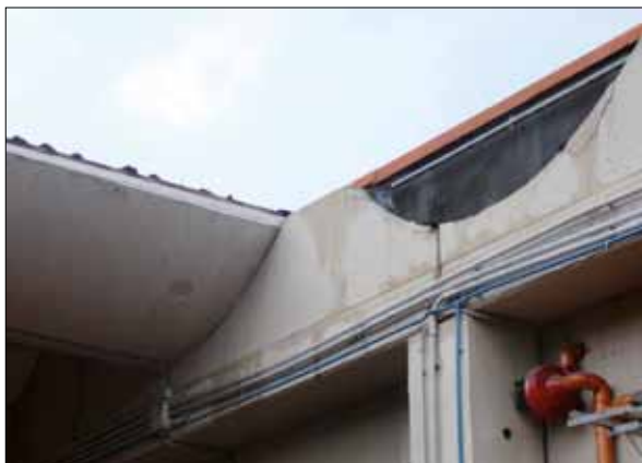
Figura 5.27: Perdita d'appoggio di un tegolo di copertura per mancanza di connettori sismici e insufficiente lunghezza d'appoggio. Livello di danno nella connessione copertura-trave: D5 (terremoto Abruzzo 2009).
