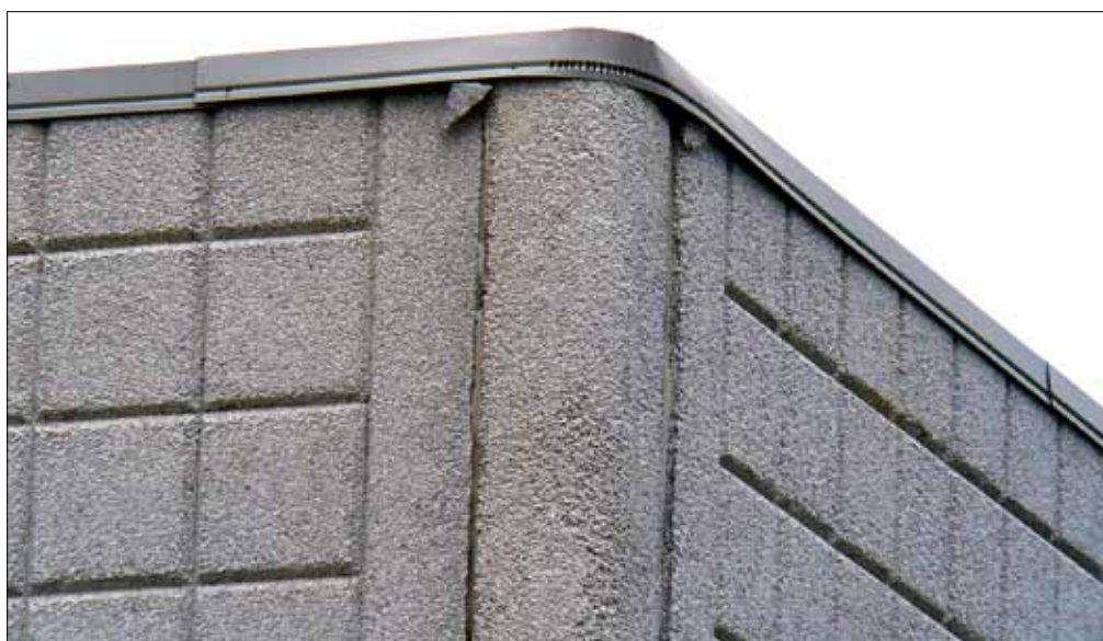
Figura 5.31: Rottura dei collegamenti pannello-struttura di un edificio prefabbricato pluripiano. Livello di danno: D4 (terremoto Abruzzo 2009, Autoparco comunale, L'Aquila)
