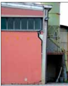
Figura 5.10: Spostamento residuo del pilastro in seguito alla formazione di cerniera plastica alla base. Livello di danno: D4 (terremoto Emilia-Romagna 2012)
