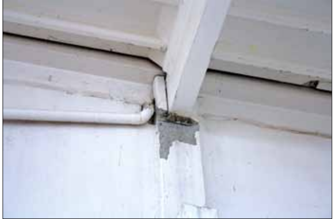
Figura 5.23: Danneggiamento dell'appoggio della trave per rottura del calcestruzzo in compressione. Livello di danno nella connessione trave-pilastro: D3 (terremoto Emilia-Romagna 2012, San Felice sul Panaro, MO)
