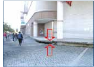
Figura 7.7: Subsidenza di 45 cm del terreno di fronte ad un centro commerciale ad Urayasu City (Giappone 2011)
