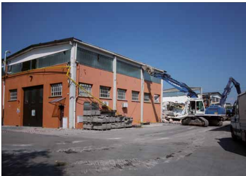
Figura 5.50: Demolizione in seguito al crollo di una parte dell'edificio (terremoto Emilia-Romagna 2012, San Felice sul Panaro (MO))
