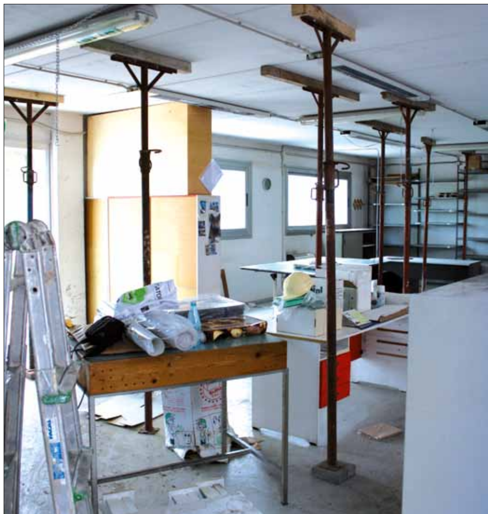
Figura 5.48: Puntellatura di un solaio di un blocco aggiunto interno in seguito al danneggiamento della connessione tra orizzontamento e struttura verticale. Livello di danno complessivo: D3 (terremoto Emilia-Romagna 2012, San Felice sul Panaro (MO))
