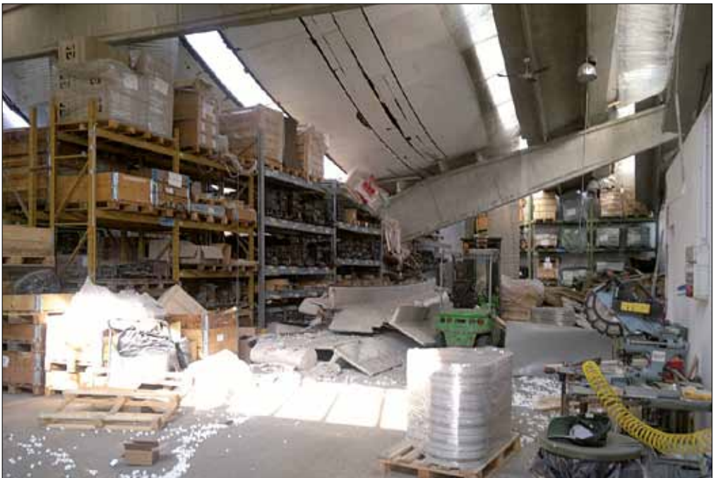
Figura 5.24: Perdita d'appoggio dei tegoli di un edificio monopiano prefabbricato con travi principali trasversali, causata dalla perdita d'appoggio della trave trasversale. Livello di danno nella connessione trave-pilastro: D5 (terremoto Emilia-Romagna 2012)
