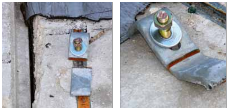
Figura 5.38: Rottura delle piastrelle di ritenuta dei collegamenti tra pannello e struttura. Livello di danno: D4 - D5 (terremoto Abruzzo 2009).
