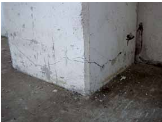
Figura 5.3: Fessurazione alla base dei pilastri di un edificio monopiano prefabbricato. Livello di danno nel pilastro: D2-D3 (terremoto Emilia-Romagna 2012)
