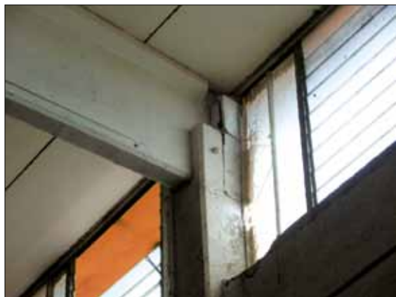
Figura 5.21: Danneggiamento della forcella del pilastro, dotata di perno di collegamento, in corrispondenza della trave. Livello di danno nella connessione trave-pilastro: D4 (terremoto Emilia-Romagna 2012, San Felice sul Panaro, MO)
