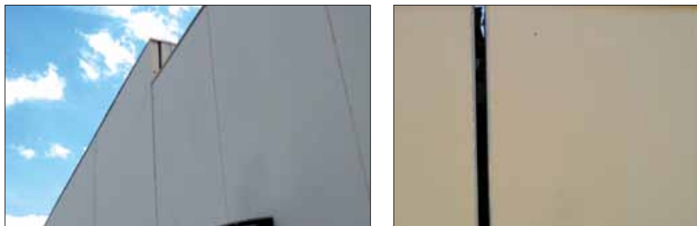
Figura 5.34: Spostamento residuo e disallineamento dei pannelli di tamponamento esterni. Livello di danno nella connessione pannello-struttura: D3 (terremoto Abruzzo 2009, Monticchio, L'Aquila)
