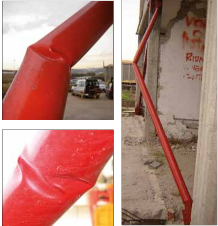
Figura 5.46: Esempi di danneggiamento dei controventi metallici: instabilizzazione legata ad un livello di danno D4
