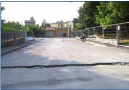
Figura 7.8: Distorsione differenziale pavimentazione stradale (terremoto Emilia-Romagna 2012)
