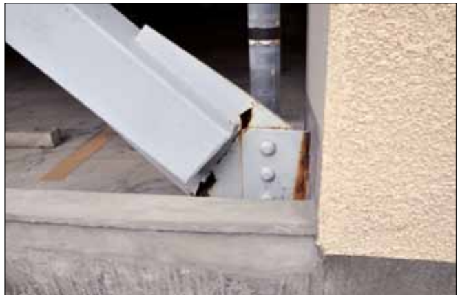
Figura 5.42: Rottura di un fazzoletto metallico a cui è collegato un diagonale di controvento di un parcheggio. Livello di danno: D4 (terremoto di Tohoku, Giappone 2011)
